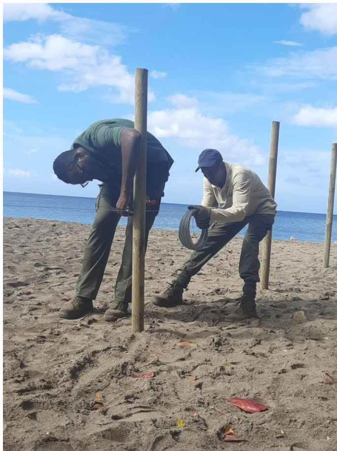
Figure 6 - installation des fils de fer, à une hauteur de 80cm, entre les piquets de l'enclos à proximité de la falaise.
