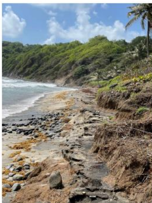
Phénomène d'érosion très important
