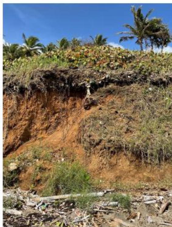
Ancienne décharge : présence de déchets à l'intérieur de la falaise (côté parking)
