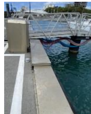
Figure 15 : Photo de l'emplacement de la pompe à eaux grises et eaux noires de la marina de l'Etang
