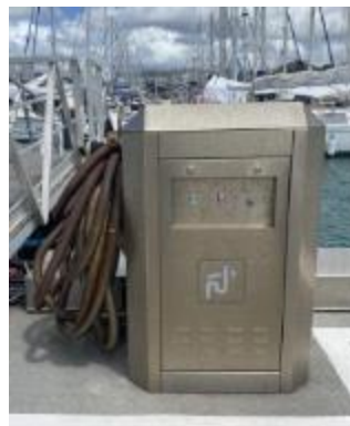
Figure 16 : photo d'une pompe à eaux grises et noires prise à la marina de l'Etang Z'Abricot
