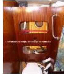
Figure 40 : Installation d'un réservoir à eaux noires dissimulé derrière les toilettes d'un bateau.
